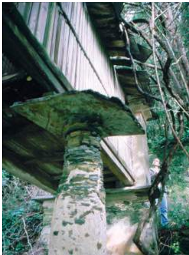
Pie de mampostería de grandes dimensiones utilizado para apuntalar una viga en el cabazo del Palacio de Figueras (Castropol), construido en 1854.
